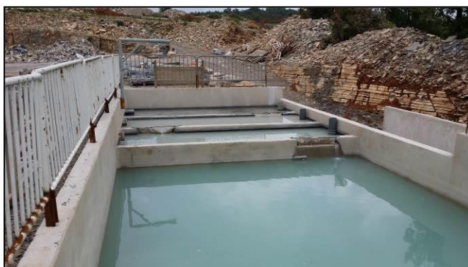
Bassin de décantation des eaux de l'atelier de sciage compartimenté
